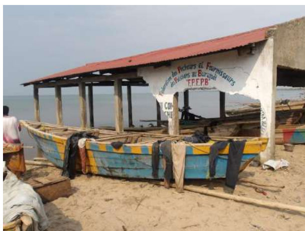
Bâtiment initialement destiné à être réhabilité pour accueillir le poste de santé de Kajaga, et détruit par les inondations de 2020
